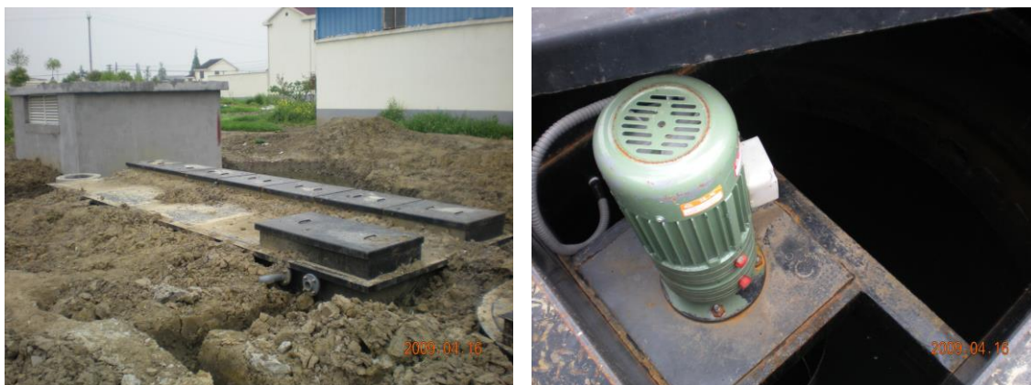
图 4-8 一体化高效滤池处理技术工程实景图
