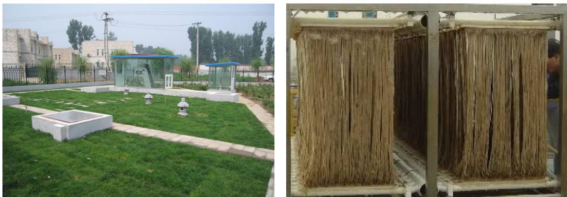
图 4-15 膜生物反应器处理技术工程实景图
